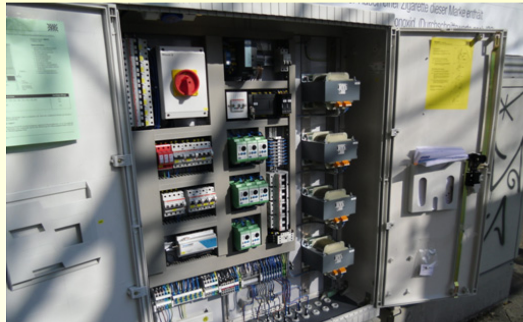
Schaltschrank für Stromversorgung / Weichenheizung
